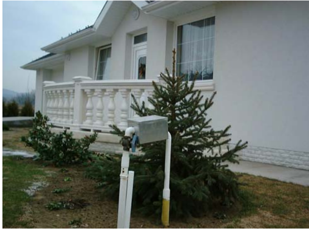
2. ábra Gáznyomás-szabályozó lakóparkban
